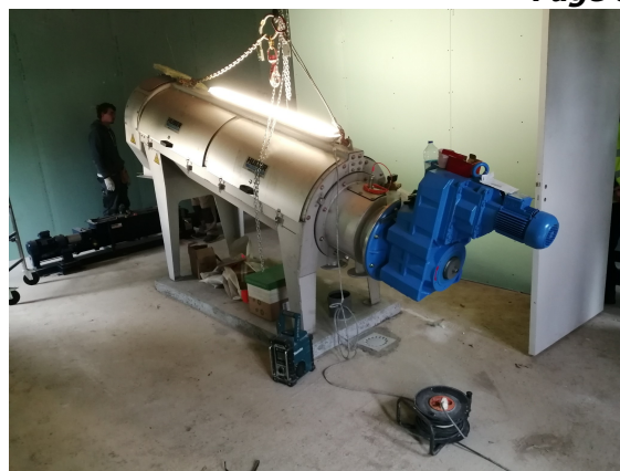
Presse à vis (traitement des boues Pouilly)
