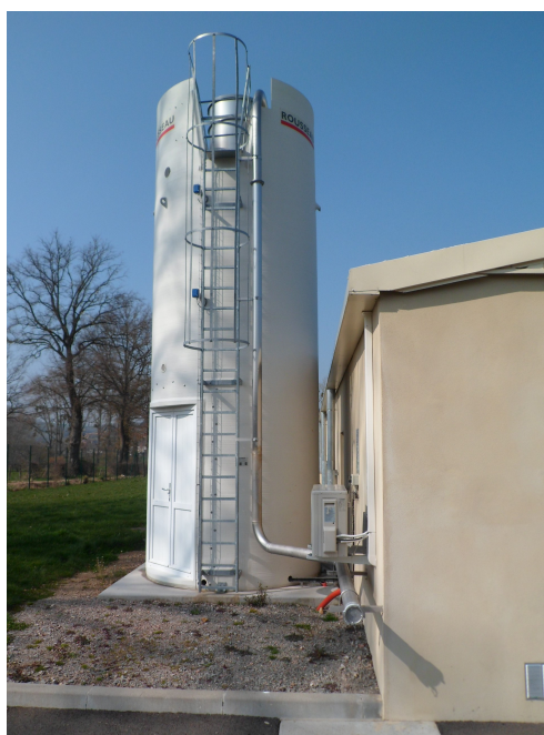
Silo de chaux
